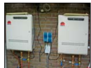
De nieuwe situatie; 2 WHX zonder rookgasafvoer
